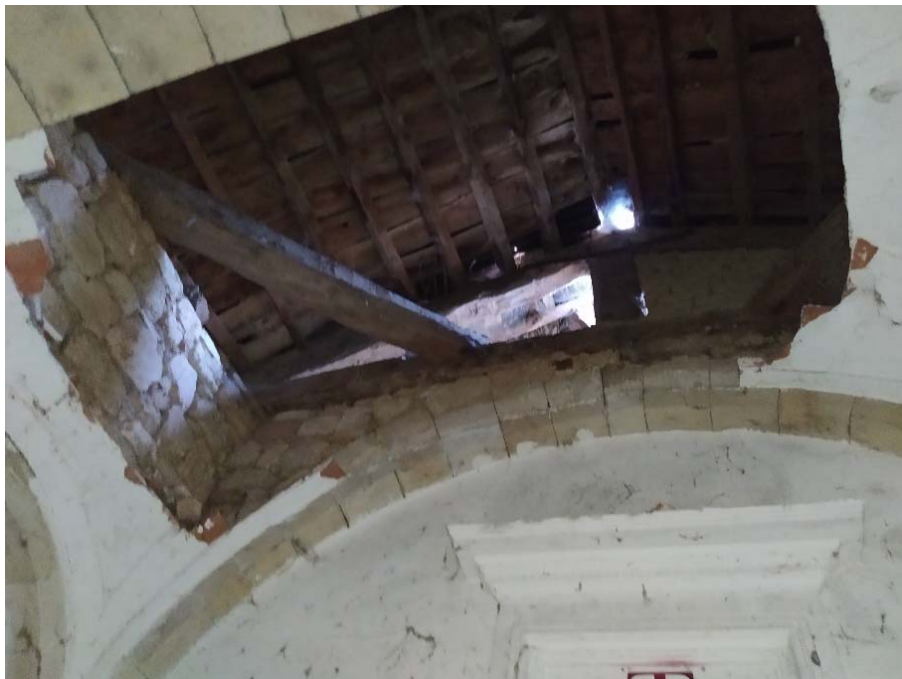
Deterioro de la cubierta en la zona del oratorio y pérdida de la bóveda tabicada. Fuente: Propia.
