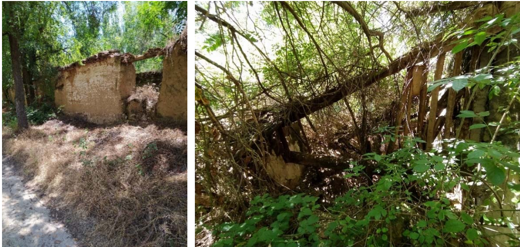
Deterioro del perímetro en la zona de huecos y presencia de vegetación en las zonas arruinadas. Fuente: Documentación gráfica elaboración propia.
